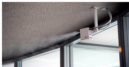
Direkt-Raumluftbefeuchtung bei BHS in Bad Vilbel.
