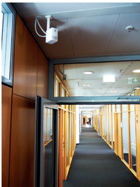
Individuelle Luftbefeuchtung in den Fluren.
